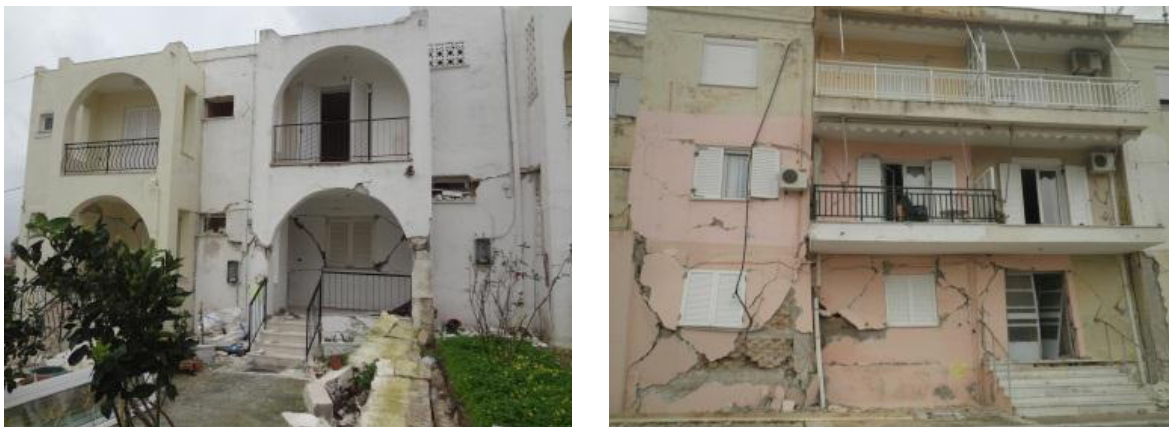
Figura 7.1.8 Complesso di case popolari gravemente danneggiato a Lixouri (EPPO, 2014)
