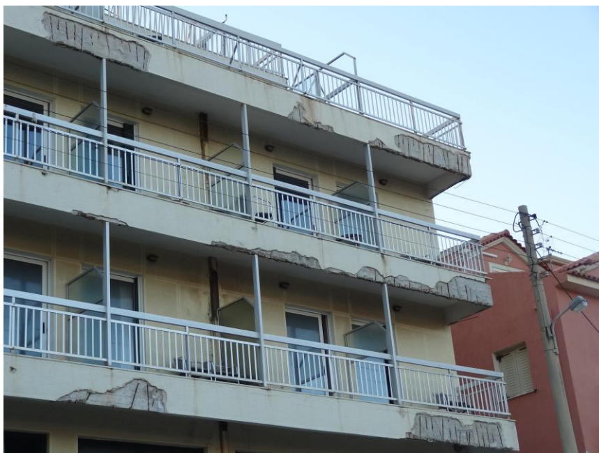
Figura 5.3 Edificio danneggiato durante il terremoto di Cefalonia in Grecia del 2014 (EPPO)
