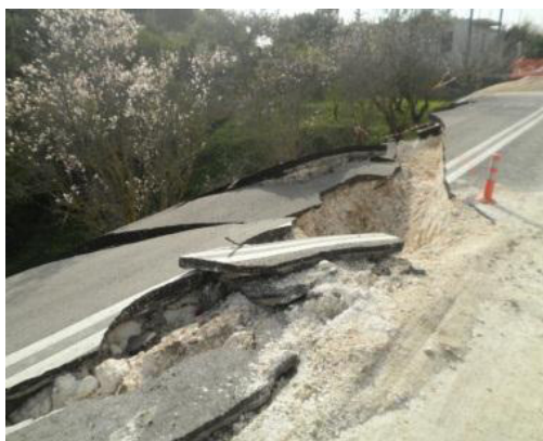
Figura 7.1.5 Danni alla rete stradale Lixouri-Havriata (EPPO, 2014)
