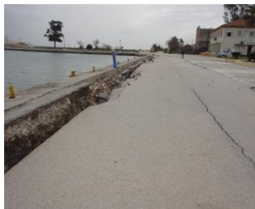
Figura 7.1.6 Danni al porto di Lixouri (EPPO, 2014)
