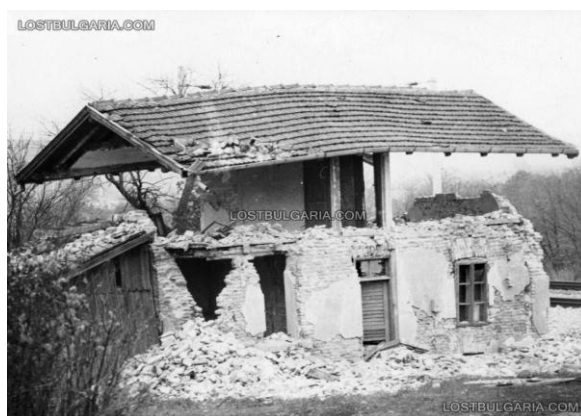
Figura 2.2.3.7 Danni causati dal terremoto, 1986 ( www.lostbulgaria.com )
