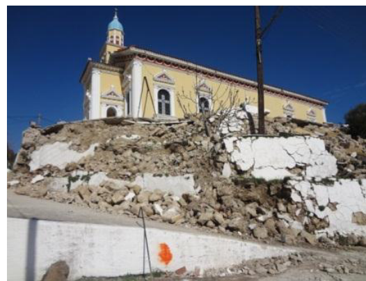
Figura 7.1.4 Danni ai muri di contenimento nel borgo di Havriata (EPPO, 2014)
